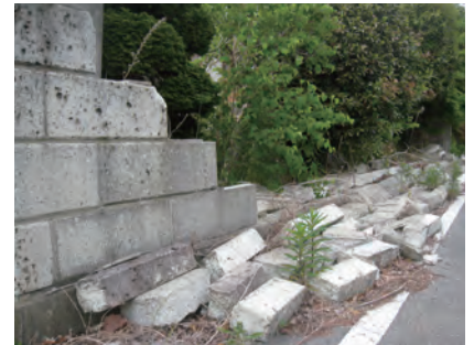
地震により石塀が倒壊
