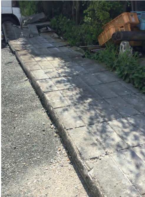
地震によりブロック塀が倒壊
